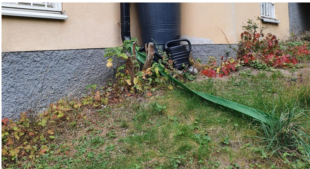
Figur 16. Avkopat stuprör med avledning till naturmark. Bostadsområdet Fader Berg m. fl..
