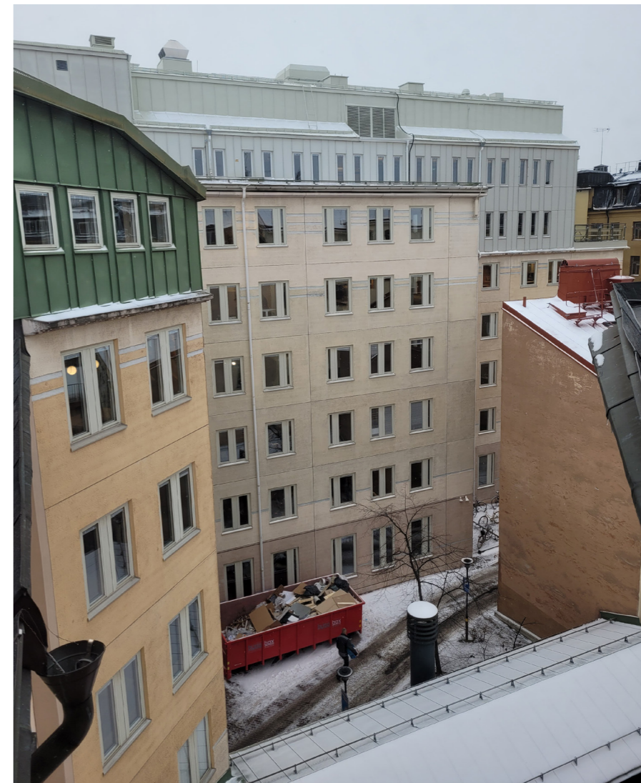
Lagern 11 sedd från Lagern 15. Teknikvåningen högst upp föreslås ersättas av ett nytt kontorsplan. Antalet fläktar, huvar och galler kommer då att minska.
