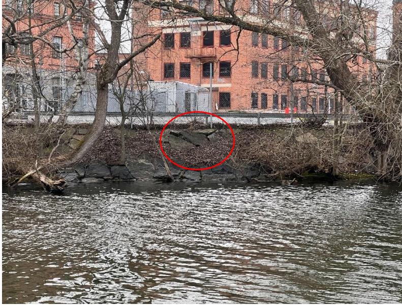
Figur 2. Bild tagen från flotte. Skada i stensättningen är markerad i rött.
