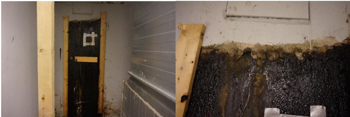
Figur 3. Inträngande avfallsolja (i fri fas) genom sprickor i pannrummet (djupare källardelen), februari 2022. (WSP 2021)
