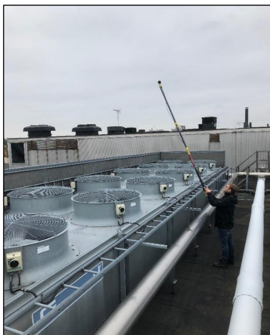
Figur 7. Kylanläggning på taket i kvarteret Tryckeriet 14.
