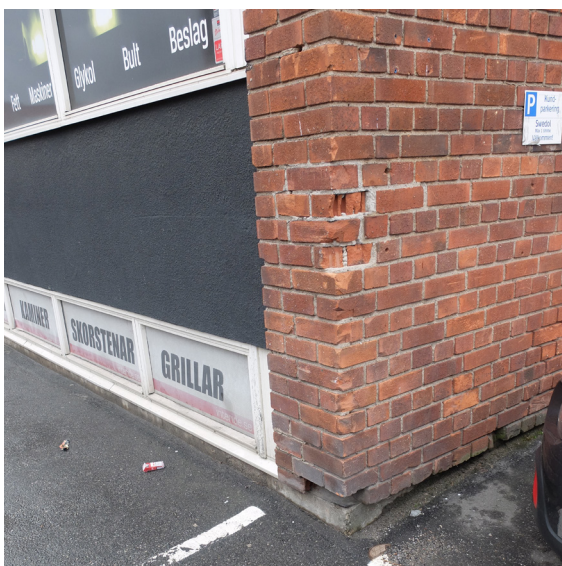
Hörnet Slakthusgatan - Charkmästargatan, ett särskilt utsatt läge som har medfört mekaniska skador.
