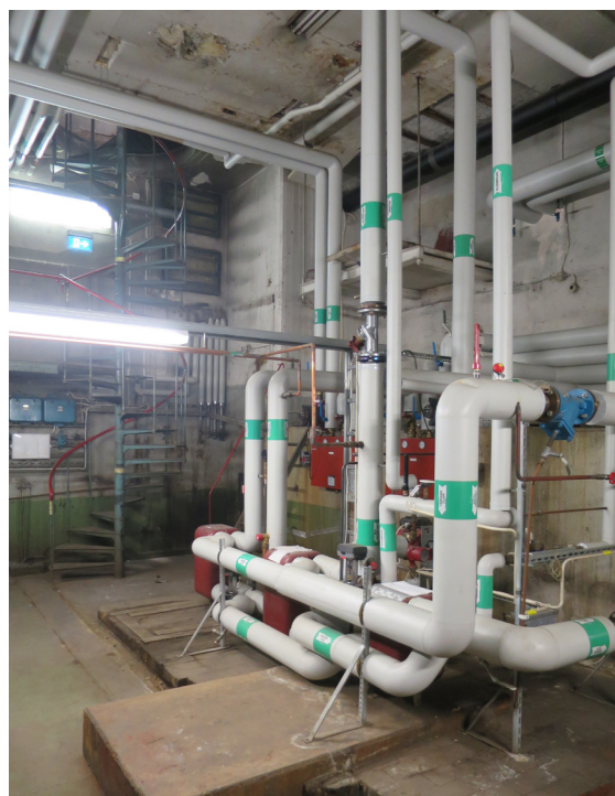
Senare tillkommen värmeanläggning i pannrummet.
