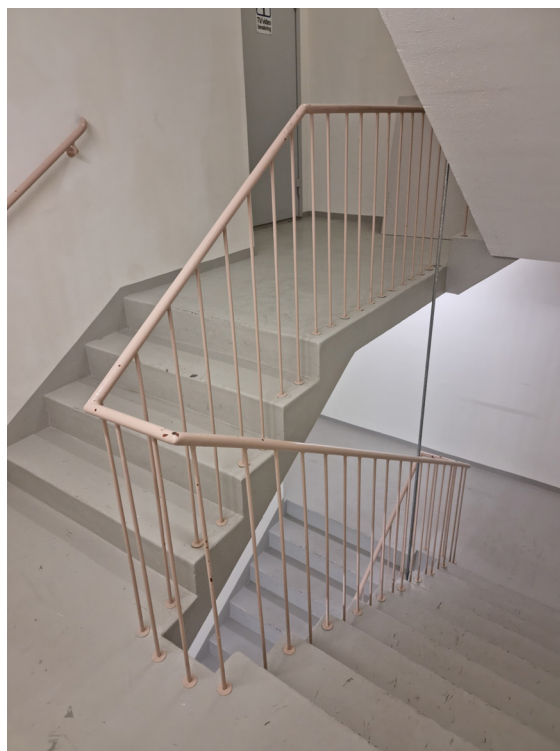
Trapplöp i det östra trapphuset.
