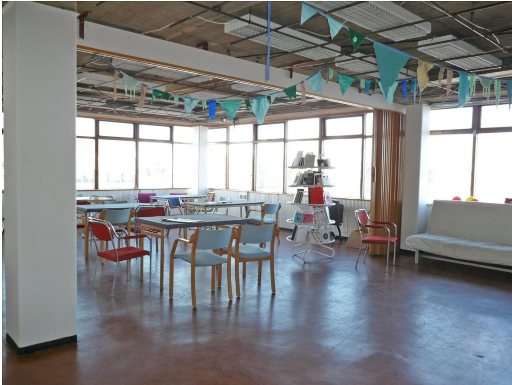
Rum 207 med kök och matsal. Funktionerna är ursprungliga men köket var större än idag. Undertaket är nedtaget (ett sekundärt undertak).
