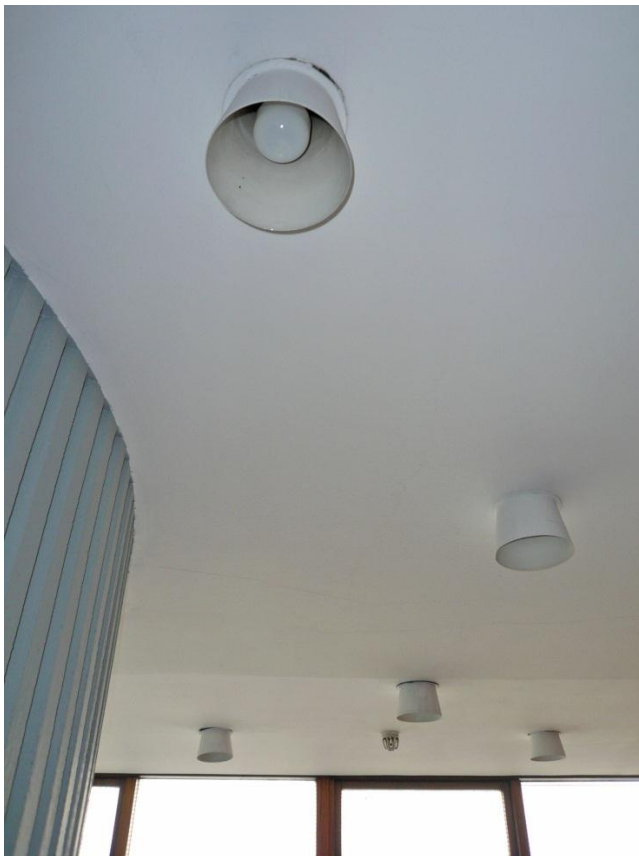
Ursprungliga armaturer med plåtskärmar på vilplan.
