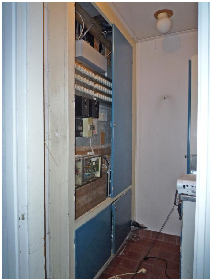
Rum 314, med ursprungligt teknikskåp.
