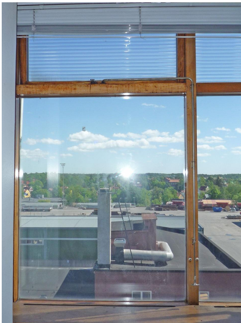
Curtainwallfasadens fönsterpartier med öppningsbara överljusfönster. Notera öppningsmekaniken i metall som gör att fönstret öppnas när man vrider på det lilla krokiga handtaget längst ner. Fönstren i överljusen har en frostad yta med ränder.
