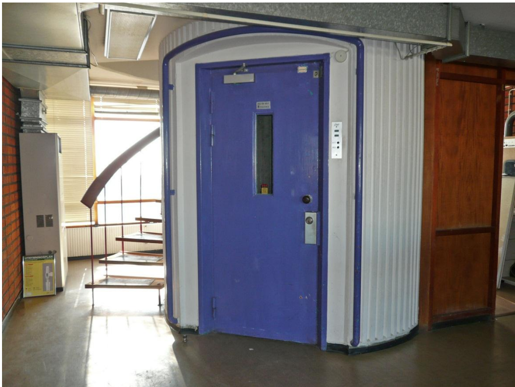
Det runda, räfflade hisschaktet och den smala interna trappan som här går upp till en av uppbyggnaderna på taket (teknikrum). Trappan har samma typ av smäckra utformning som den representativa interntrappan mellan plan 3 och 4.
