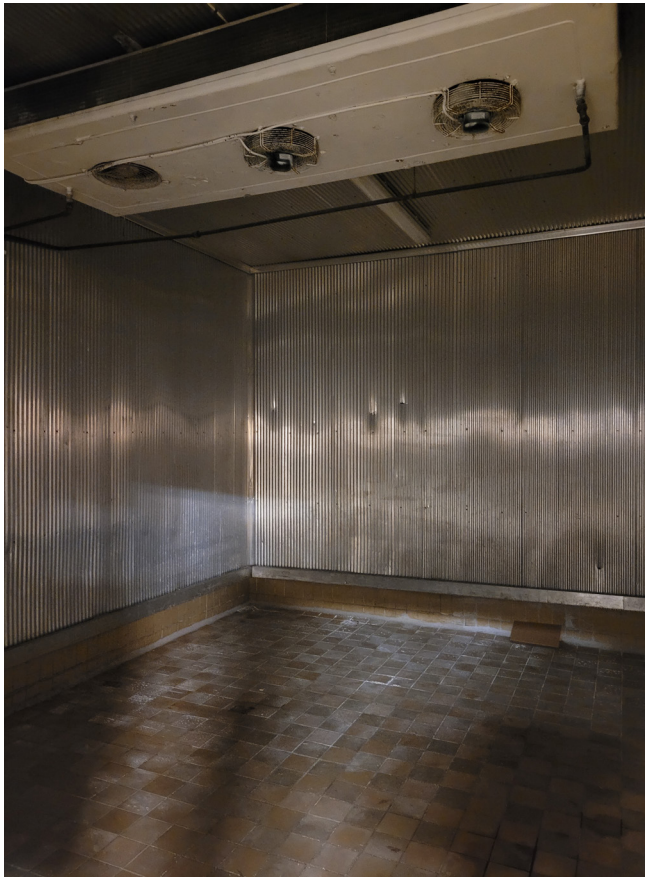
I anläggningen finns flera kyl- och frysrum, här ett som bedöms tillhöra de äldre (Del 2).
