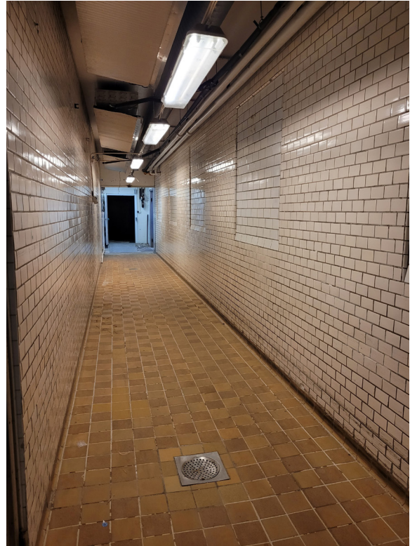
Passage i bottenvåning i Del 2 med fönsteröppningar som stängts och kaklats vid tillbyggnad på 1960-talet.
