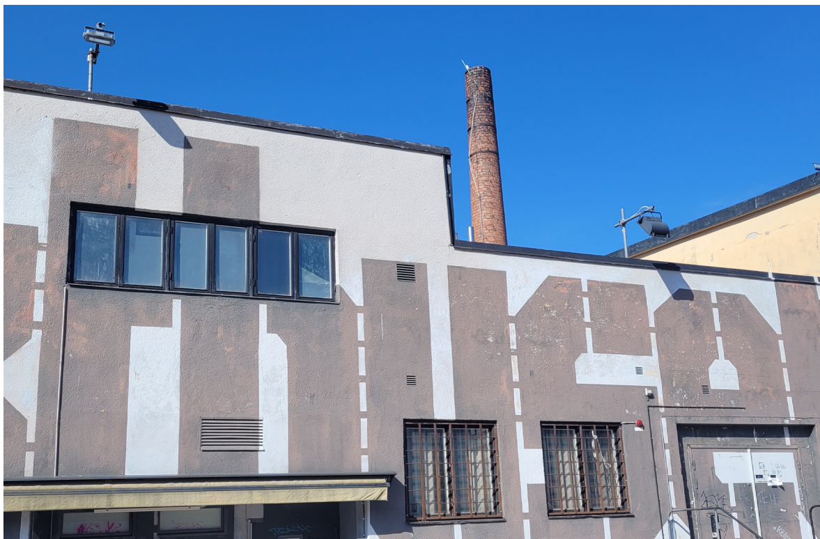
Skorstenen tillkom på 1950-talet och är genom sitt indragna läge inte alltid framträdande.
