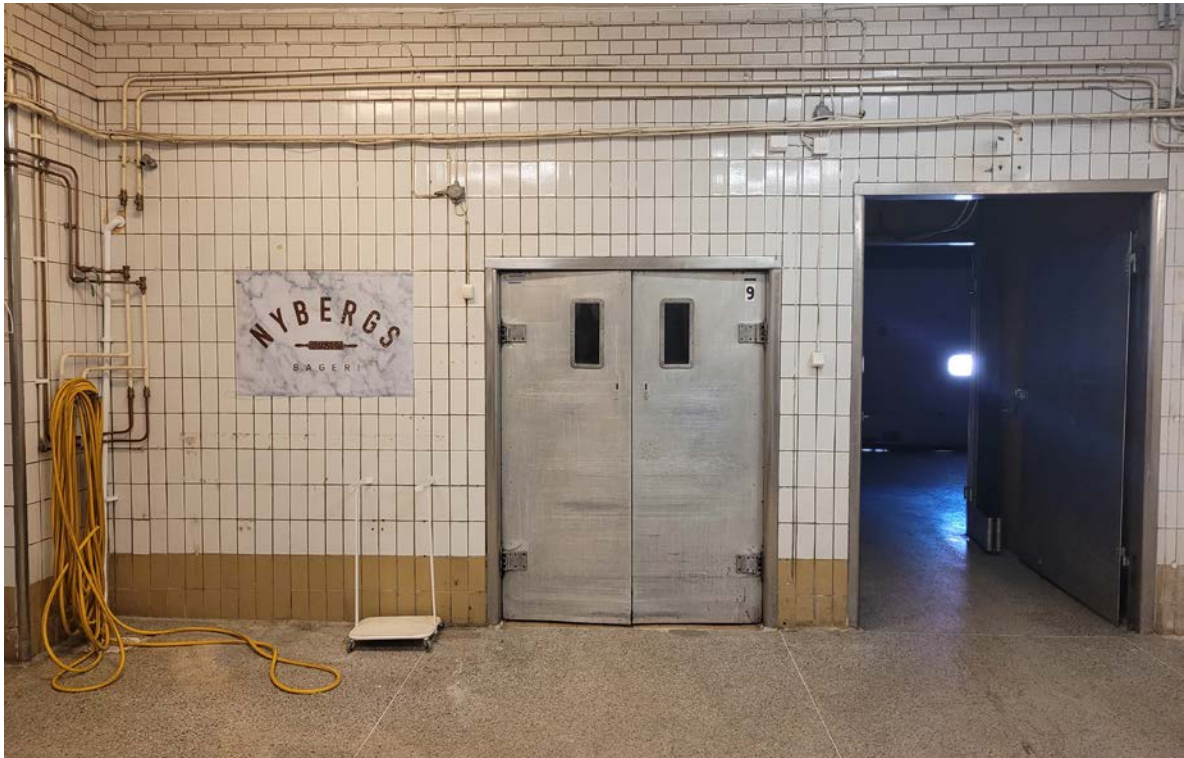
Rangeringsyta i byggnadens norra del (Del 2) med kakelbeklädning från 1960-talet och terrazzogolv. Golven i fabrikslokalerna är anpassade för daglig avspolning. Detta har orsakat skador på stomme och ytskikt då tätskikten åldrats eller varit otillräckliga.
