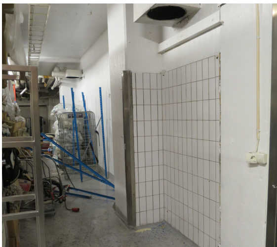
Källarvåningen. Kakel på del av väggen. Kakel på väggar är kvar sedan den ursprungliga grossistverksamheten.
