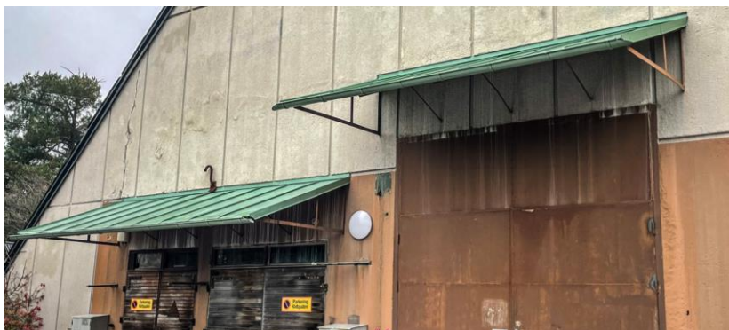
På panncentralens södra gavel finns två skärmtak som kan fungera som inspiration för skärmtak till kontorsbyggnaden (foto: Nyréns arkitekter).
