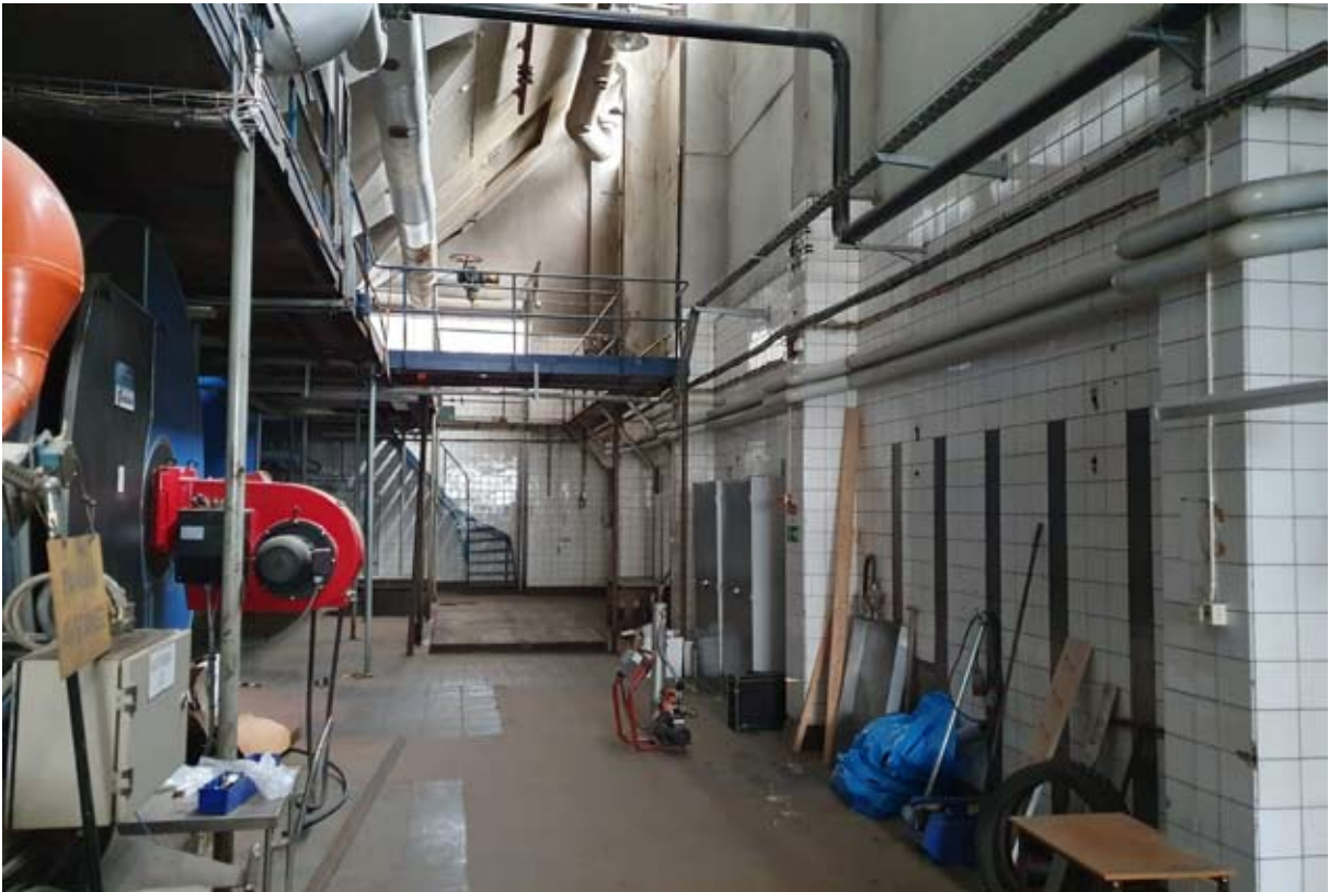
Interiör från pannrummet. Även om den tekniska utrustningen är utbytt är det mesta av den fasta inredningen ursprunglig.
