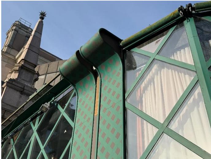
Pilasterformade plåtavtäckningar, observera den förgyllda ytan mellan plåtarna, detta kan vara ett senare tillägg. I Celsings arbetshandlingar är rören angivna som Cu-rör. Dessa kom inte till utförande, sannolikt beroende på korrosionsrisk mot övrig metall i fasaden.
