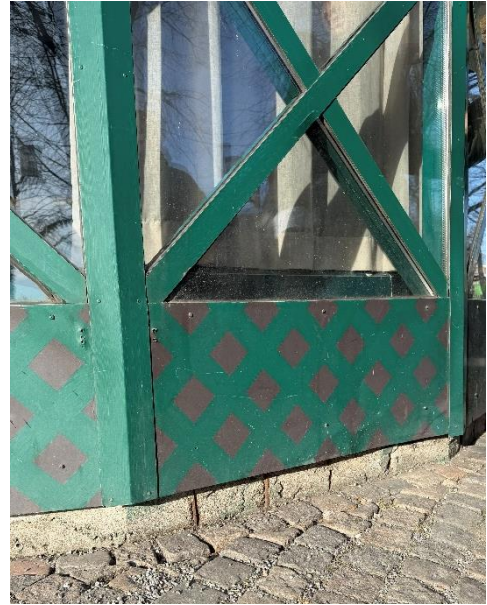
Skador på betongsockel och plåtar. Målning kompletterad med penselmålning på plats i felaktig grå kulör.
