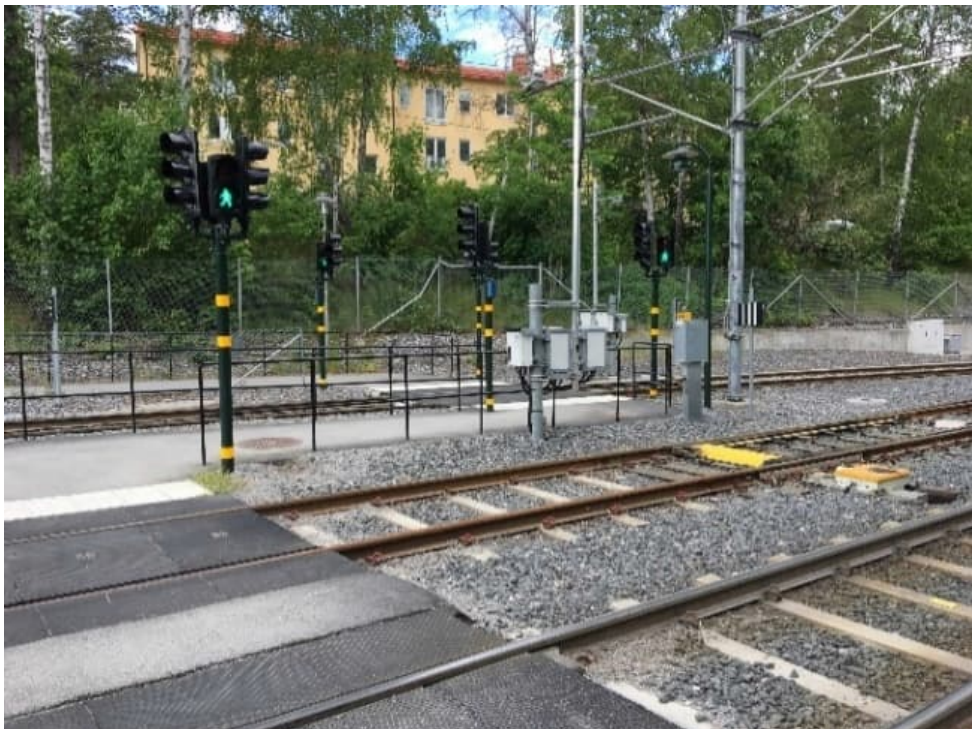
Foto 1 Saxad passage över spåren vid Alviks strand hållplats för Tvärbanan (utanför detaljplanens område).
