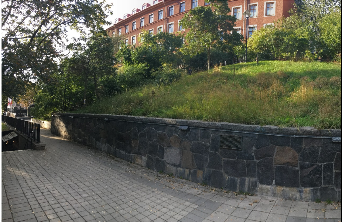
Bild 1. Slänten vid trappan upp mot moskén
