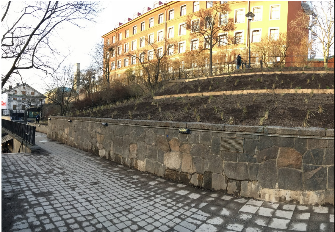
Bild 1, Slänten vid trappan upp mot moskén
