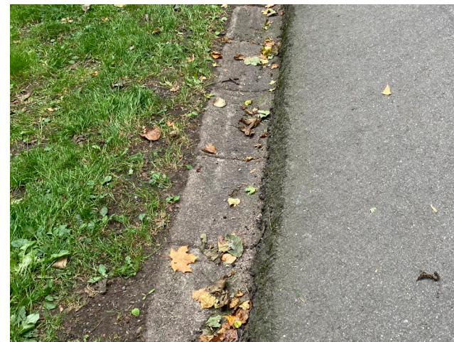
Bilden visar en trasig ränndal i betong, som bör bytas ut till en ränndal i natursten.
