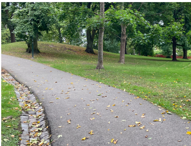
Bilden visar en rännal i gatsten på ena sidan av gångvägen, men inte på den andra sidan. Framöver bör rännalar tillkomma på båda sidor av gångvägarna.
