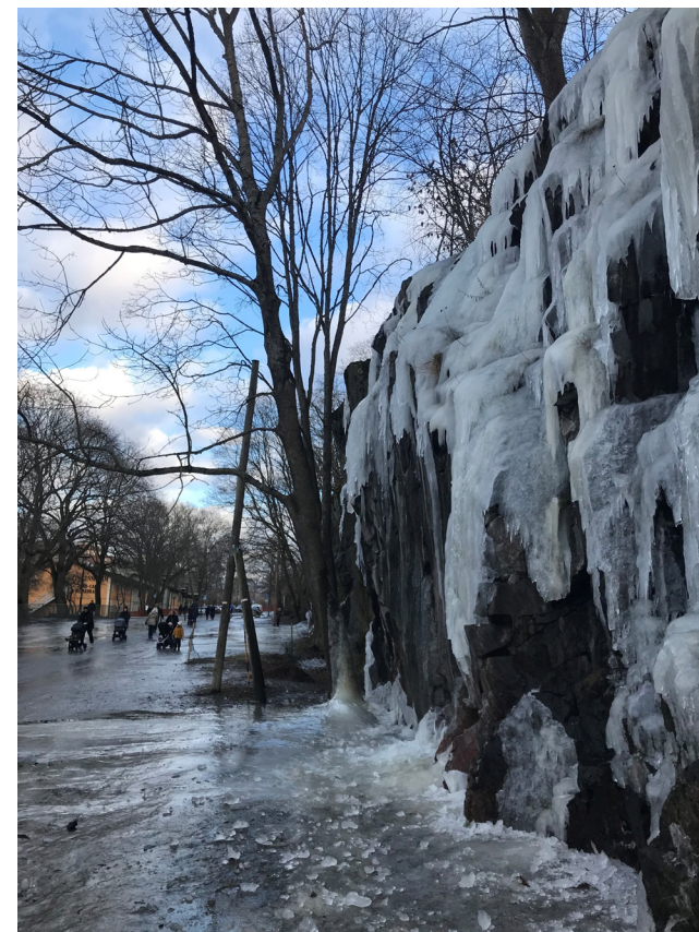
Bilden visar följden av stora regnflöden på vintern. Nedanför Tantoberget har stora istappar bildats, som hänger ut över bergskanten. Marken intill är rena isbanor. Det är viktigt att se till att inte istapparna kan skada någon. För andra är de vackra att betrakta.
