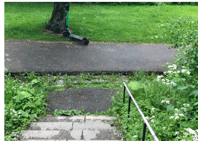
Asfalt på Tantolundens gångvägar har lagats och byggts på i omgångar utan att göras om från grunden. Därav finns på sina håll stora nivåskillnader mot anslutande mark.
