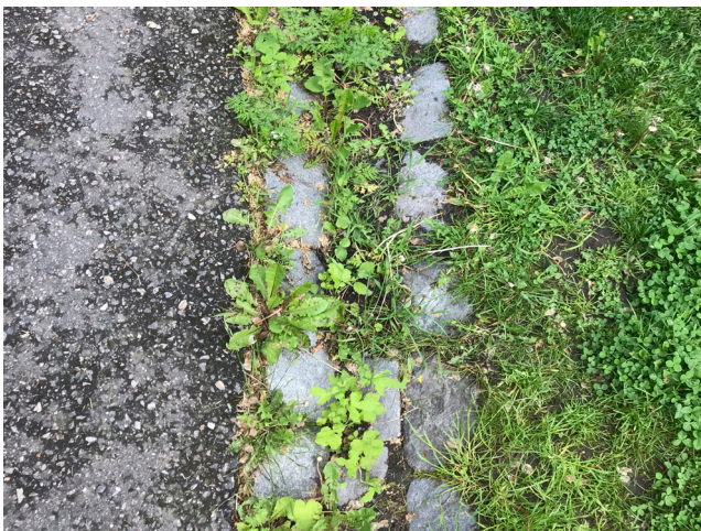
Bilden exemplifierar hur ogräs växer upp i en ränndal av storgatsten i Tantolunden efter eftersatt ogrärensning av rännalarna.
