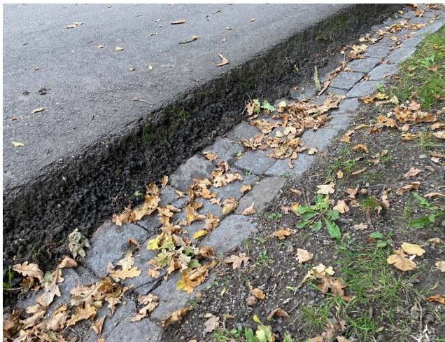
På bilden syns hur gångvägen i asfalt ligger upphöjt i förhållande till rännalen i storgatsten. Asfaltkanten är brant och man riskerar att snubbla om man trampar fel.
