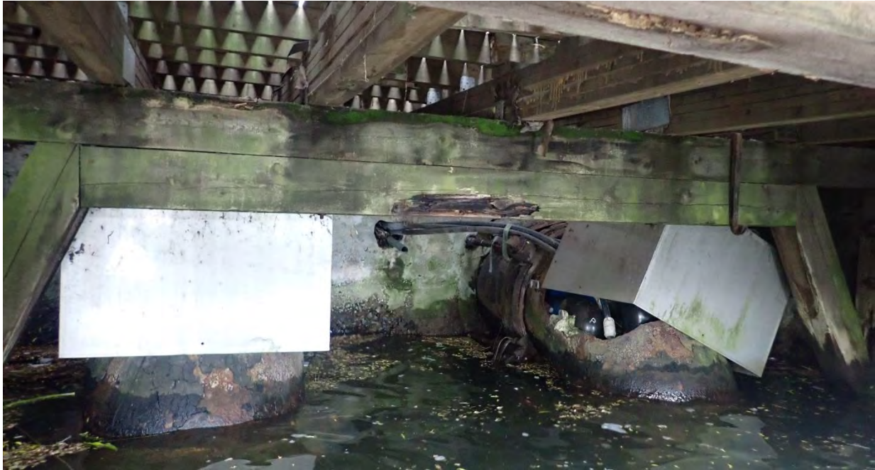
Foto 11 – visar underbyggnaden av egentillverkade "limträbalkar" som bärs upp av det kraftiga mittreuplaget som är i bättre skick än det yttre, men ändå med lokala rötskador.
