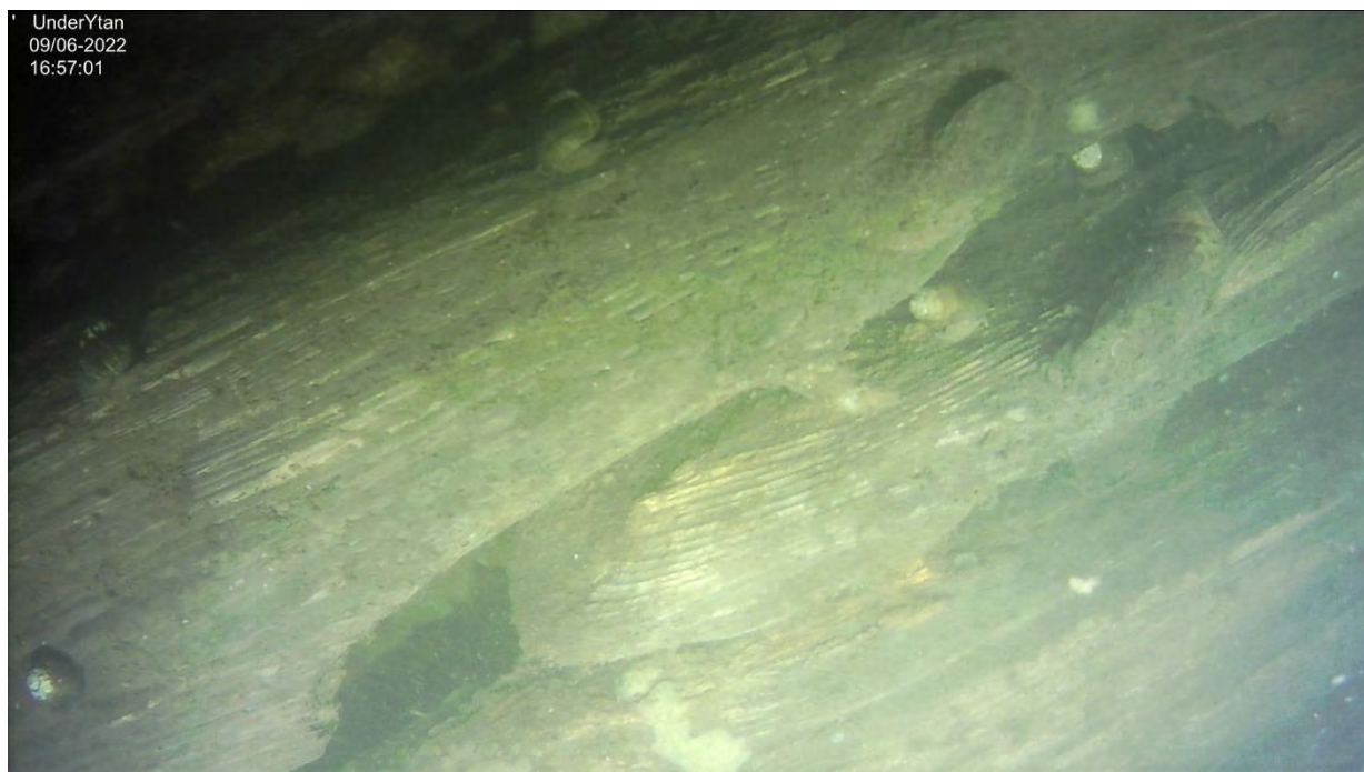
Foto 8 – visar detalj av det eroderade men ändå stumma virket i stenkista nr 3.
