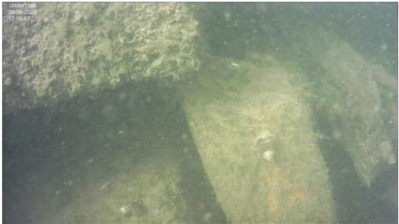
Foto 5 – visar stående stock som bär stor del av lasten från överbyggnaden. Till vänster noteras håligheter på grund av dålig betong.
