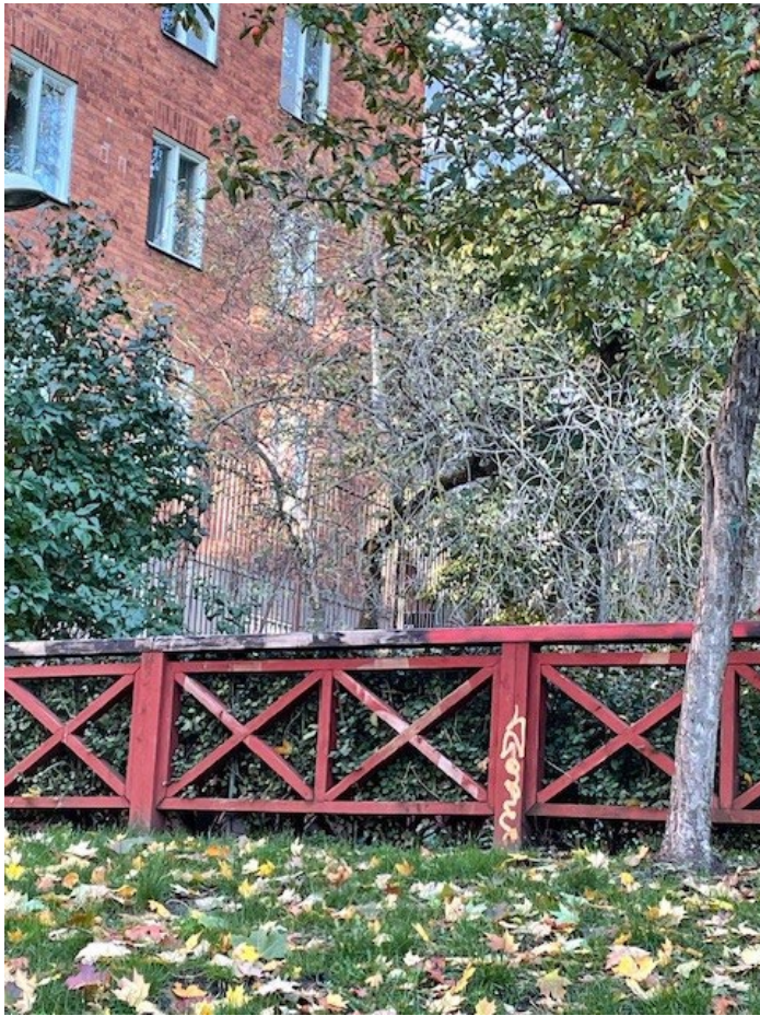
Bild 3: Staket runt planteringsytorna som är i behov av översyn. Foto: Södermalms stadsdelsförvaltning.
