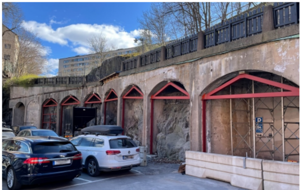
Den befintliga rampen har förstärkts tillfälligt, till dess en långsiktig lösning kan genomföras. Foto: SBK
