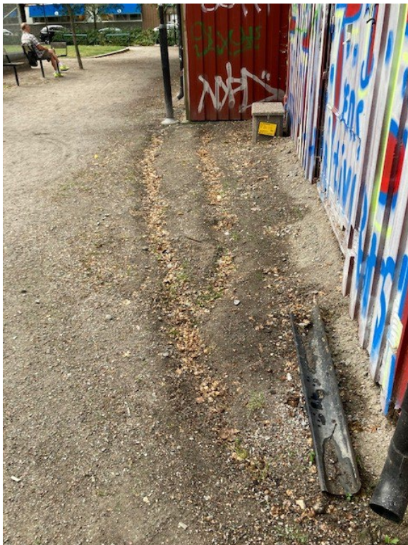
Bild på erosionsskada i parken Droskan. Bild: Södermalms stadsdelsförvaltning 2021.
