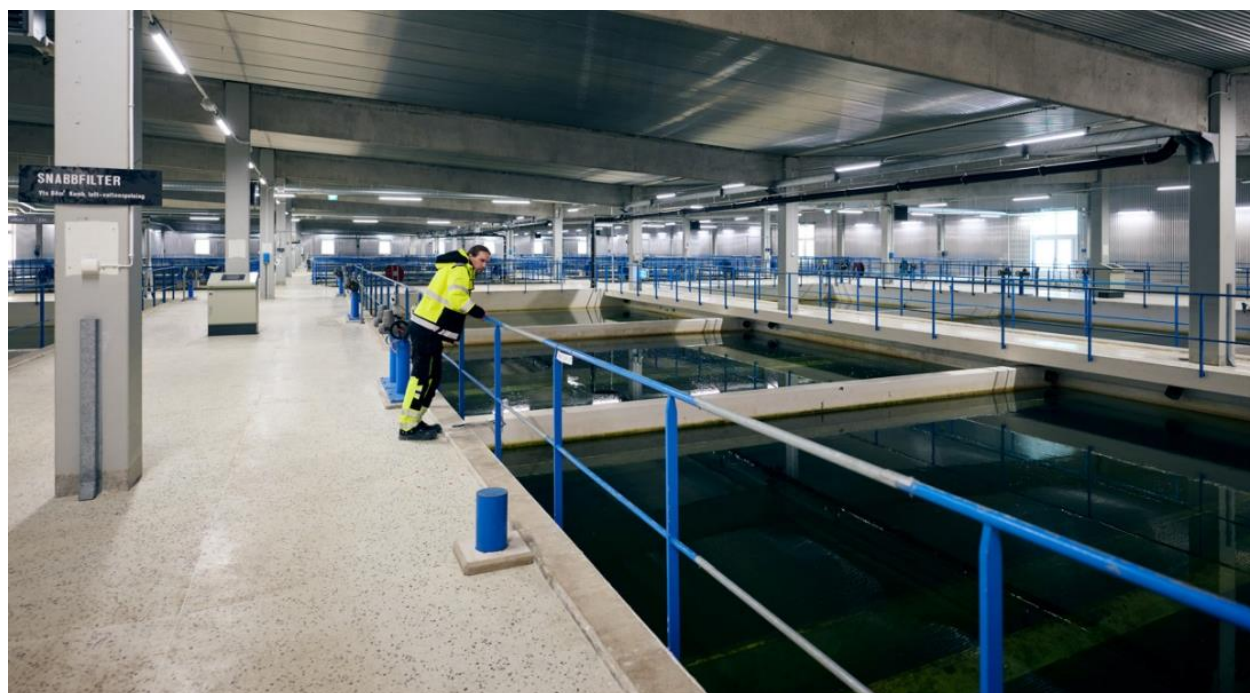
Dricksvattenproduktion på Norsborgs vattenverk.
