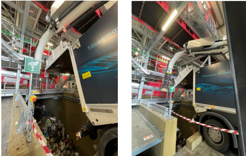
Figur 6. Exempel på hur det ser ut då ett insamlingsfordon tippas in avfall i anläggningen.
