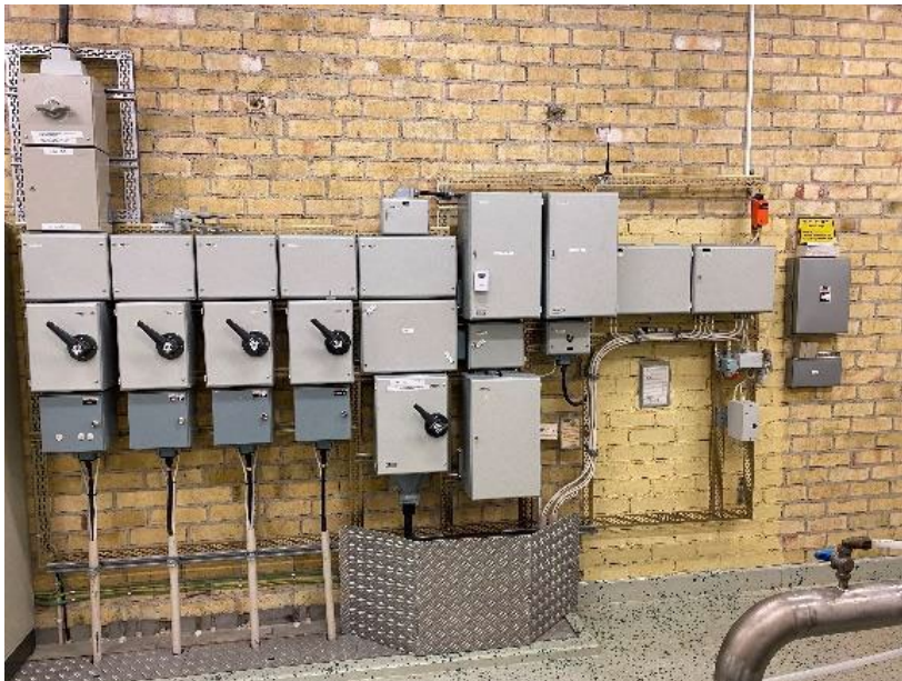
Figur 1. Nybohov vattenpumpstations ställverk från 1996.
