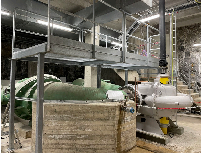
Nya råvattenpump 10, som togs i drift vecka 25 2024.
