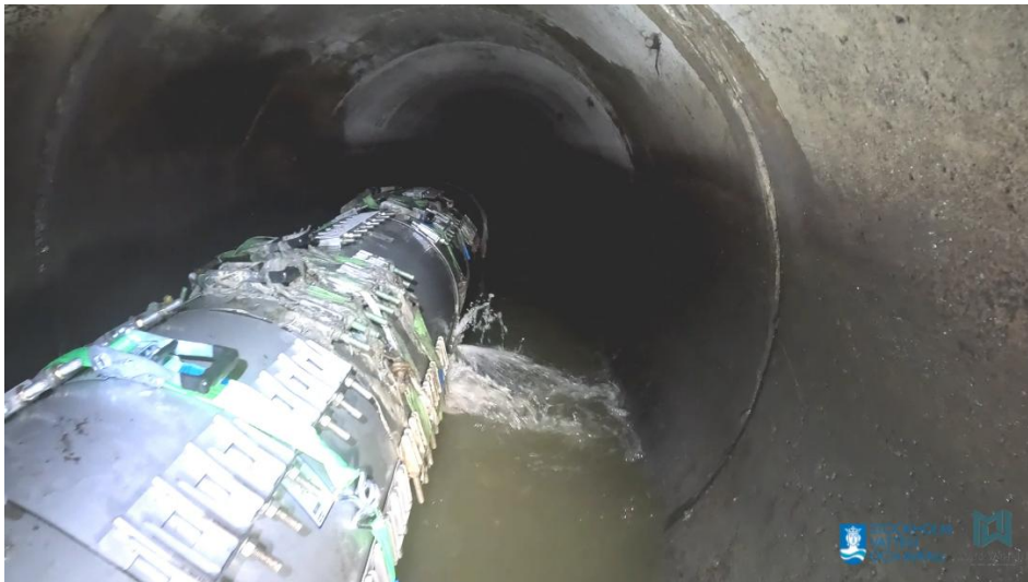
Figur 2 Lagning med svep, fortsatt läckage, januari 2026
