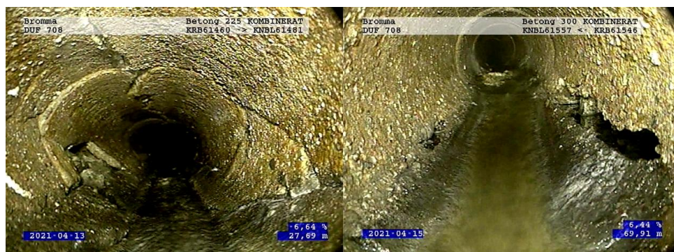
Figur 1 Exempel på konditionsbrister från rörinspektion av ledningarna i Stopvägen. Till vänster ett exempel på rörbrott och till höger frätskada där del av rörvägg saknas.
