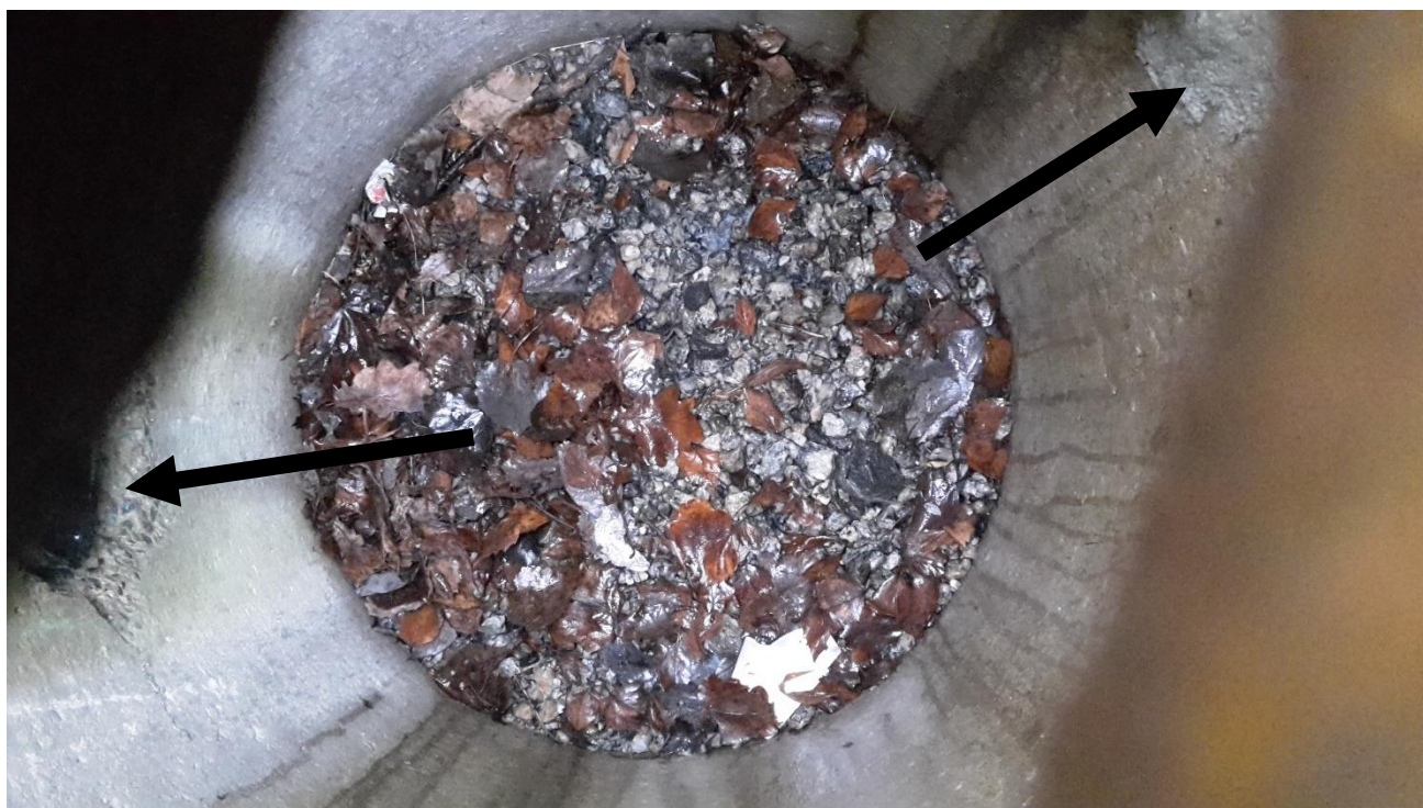
Bilaga fig 4. Inuti samma brunn. En utgående och ingående ledning identifieras.
