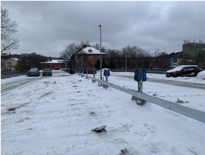
Fundament med täckta kabelskenor
